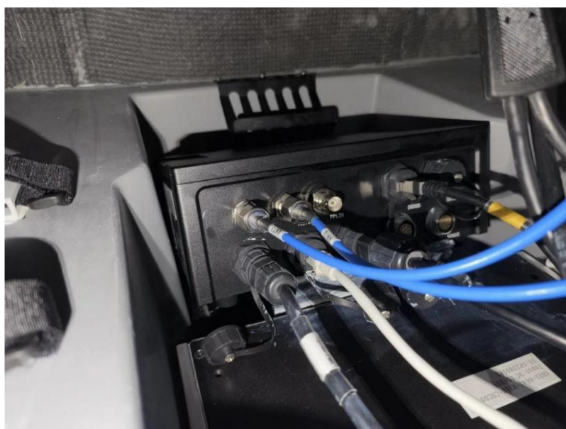
Figure 2-10 Connectez les câbles conformément aux étiquettes figurant sur les câbles et correspondant aux interfaces.
